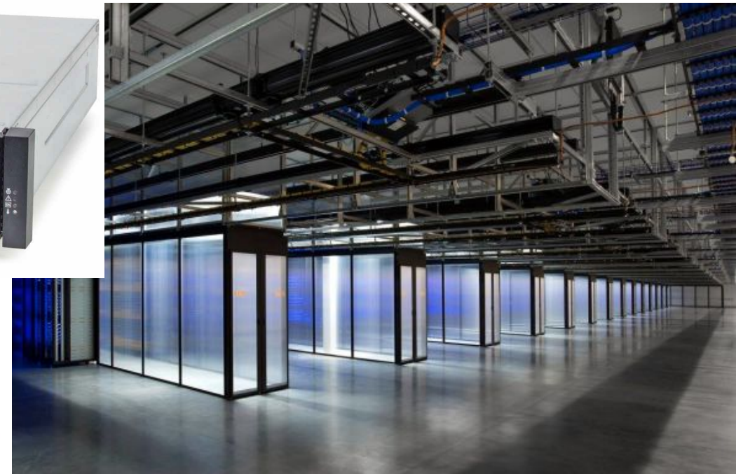
Centro de datos de Facebook (Altoona, Iowa) alimentado por un parque eólico.
